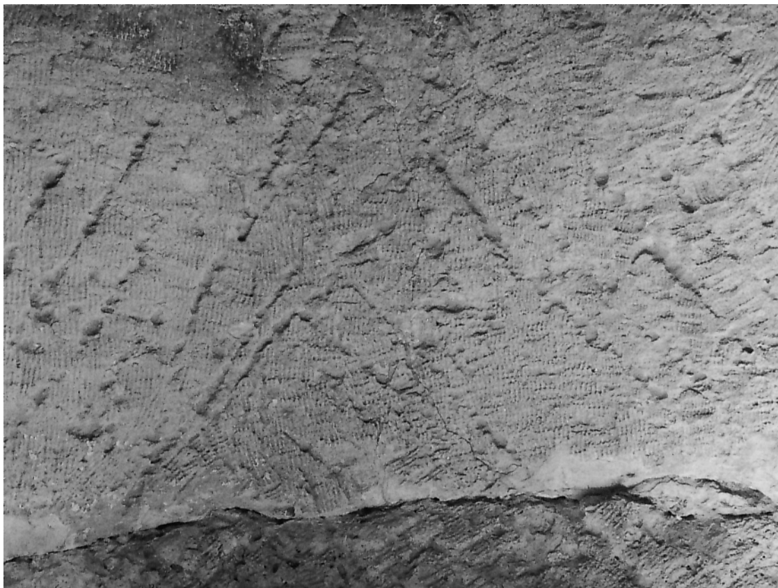
Фото 13. Характер обработки стен помещения №2.
