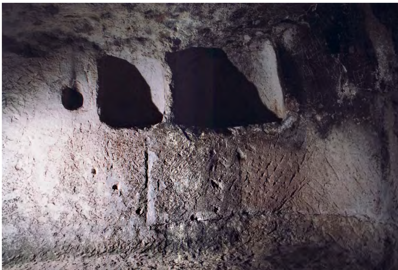
Фото 33. Следы срубленного выступа на северной стене помещения №2.
