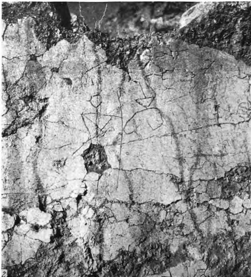
Рис. 4. Штукатурка с граффити на западной стене здания
