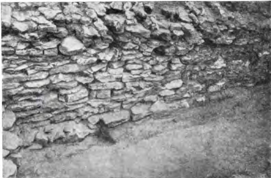
Рис. 5. Внешний вид северной стены дромоса с внутренней стороны (хорошо заметны продольные и поперечные пустоты от бревен)
