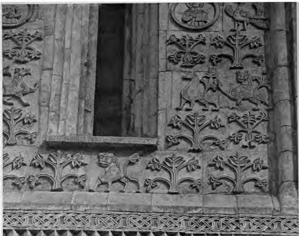
Рис. 4. Рельефы левого прясла южного фасада (1—5-й ряды). Дмитриевский собор во Владимире (фото автора)
